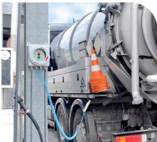
Mise à la terre active de camions-citernes
